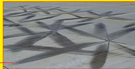
Stationäre Tausalz- Sprühanlage
